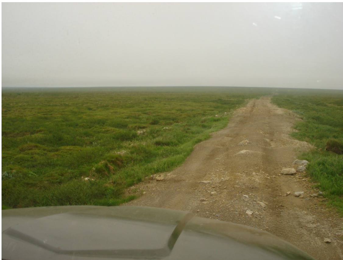
Рис. 6 – Состояние автодорог в настоящий момент времени
