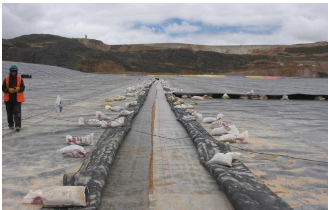
Рис. 8 – Сжатие геосинтетических глинистых экранов и разделение панели из-за недостаточного перекрытия
