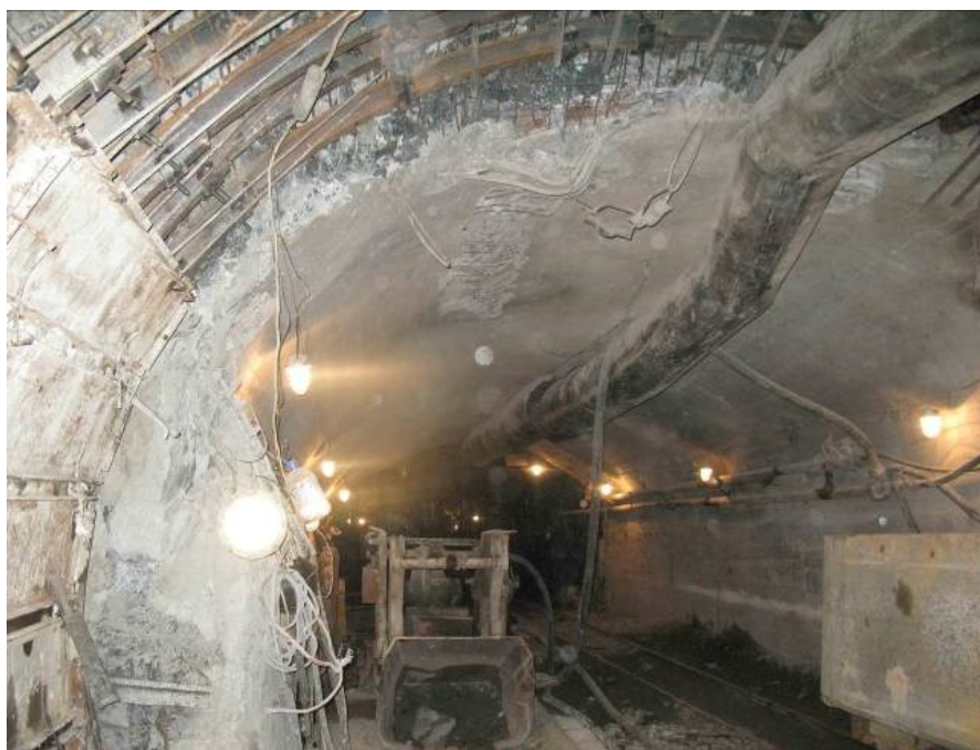
Рис. 3 – Нарушения железобетонной крепи в порожняковой ветви выработки сопряжения гор. –560 м ствола «Клетевой»
