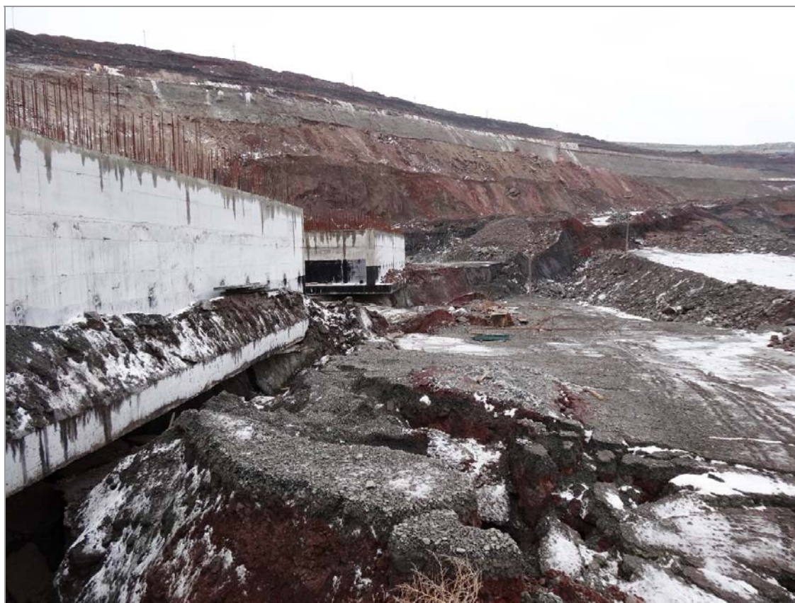
Рис. 2. Эпицентр аварии на борту карьера при строительстве подпорных стенок
