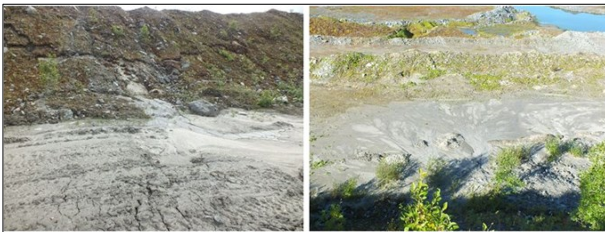
Рис. 1 – Следы суффозионного выноса материала насыпного ГТС
