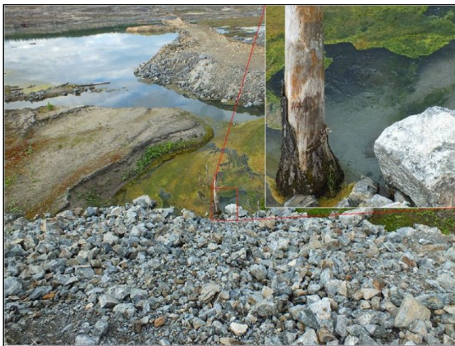
Рис. 5 – Фонтанирование воды у основания сооружения
