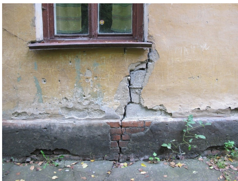
Рис. 3 – Трещины в подрабатываемом сооружении
