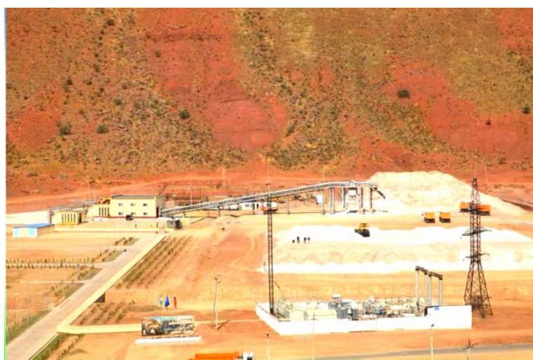
Рис. 3. Участок предварительной подготовки горных пород, складирования и хранения усредненной сильвинитовой руды
