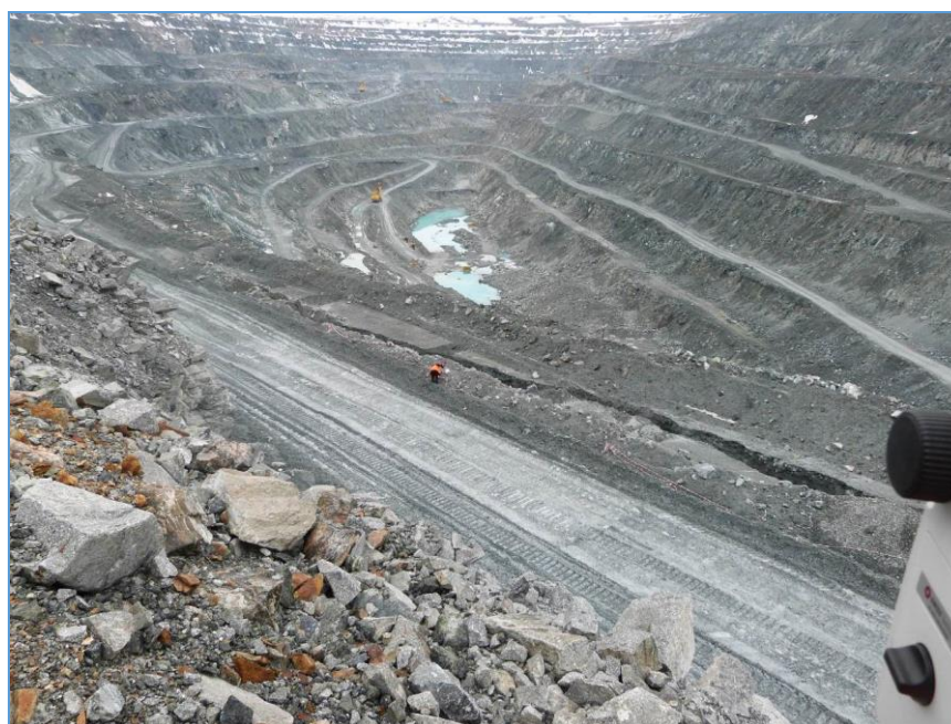
Рис. 3. Раскрытие трещины в 2016 г.
