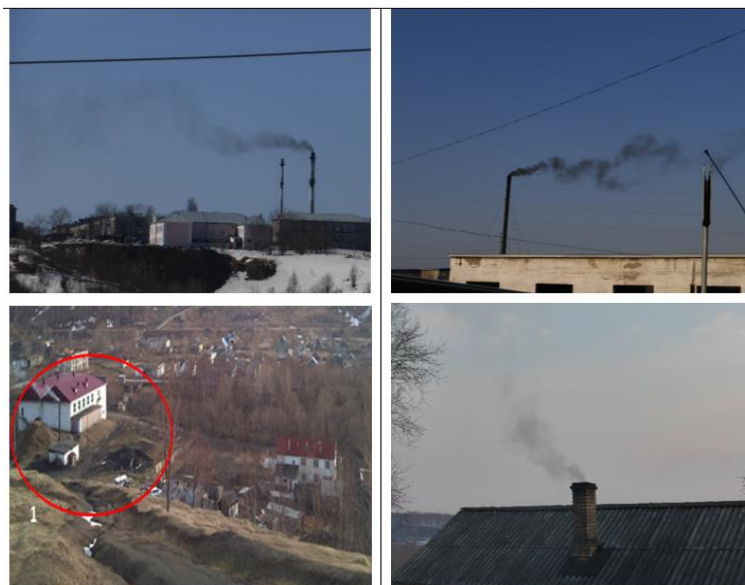
Рис. 3. Варианты отопления п.г.т. Шахтерск, Углегорский р-н Сахалинской обл. (Слева направо: Котельная «Районная», котельная «Керамик», котельная спортивной школы, печное отопление)
