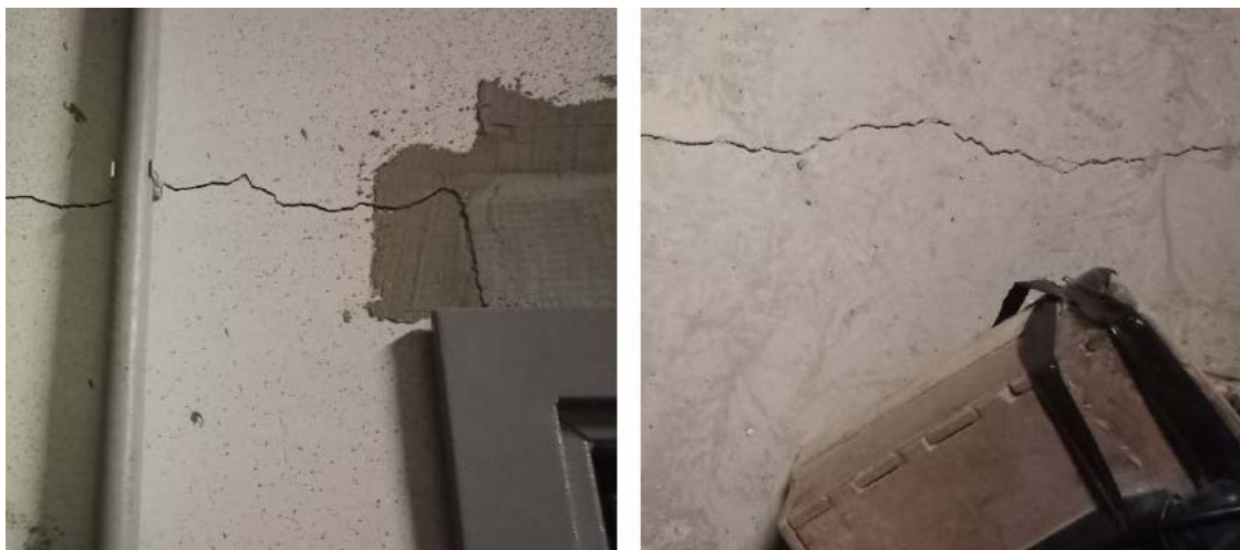
Рис. 1. Фотографии трещин шахтного эксплуатационного копра
