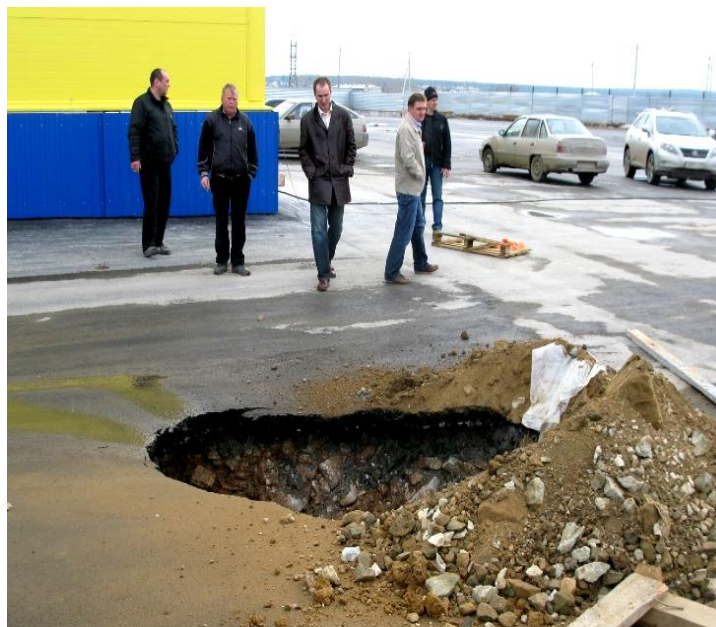
Рис. 1. Территория г. Березовский. Образование провала над старательской горной выработкой. Горнотехническая документация по данной выработке отсутствует
