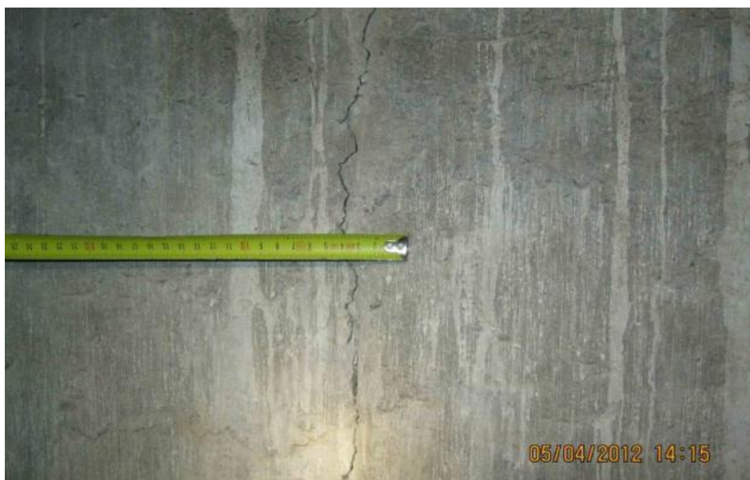
Рис. 1 – Вертикальная трещина в железобетонной крепи ствола «Южный Вентиляционный» в интервале глубин 40 – 52 м
