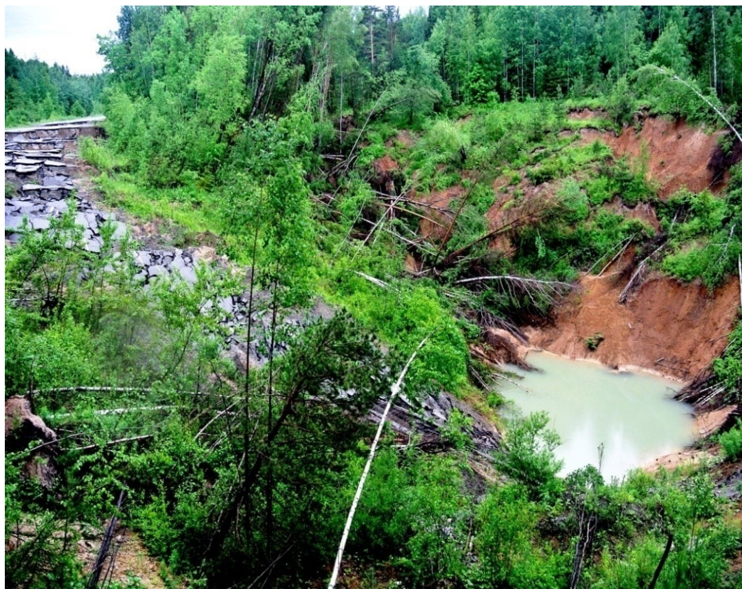
Рис.2 – Фактическое состояние зоны обрушения и бывшей автодороги
